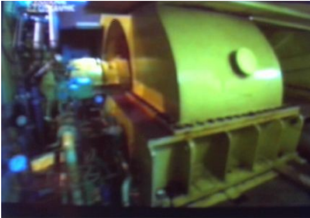
A KALIFORNIAI GEOTERMIKUS ERŐMŰ EGYIK GŐZTURBIÁJA KÜLÖNLEGES ÉPÍTMÉNYEK, GEOTERMIKUS ERŐK National Geographic TV 2008. április 14. (Kód: GeotermKaliforniaGozturb)
